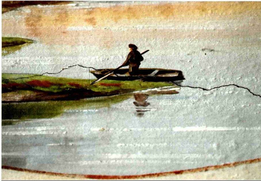
Risse im Treppenhaus: Noch sind die Motive des Deckengemäldes zu erkennen.
