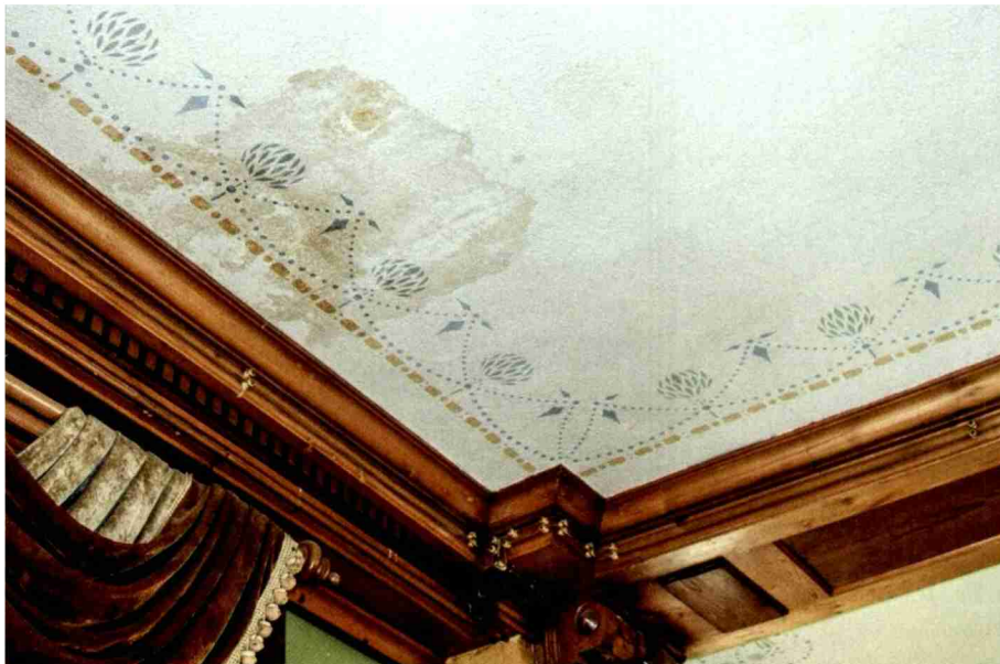
Wasserschaden im Jugendstilsaal: Eine Notsicherung konnte 2012 Schlimmeres verhindern.
