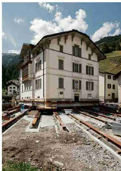
Auf Schienen gestellt: In zwei Etappen wird nächste Woche in Mulegns die «Weisse Villa» verschoben.
