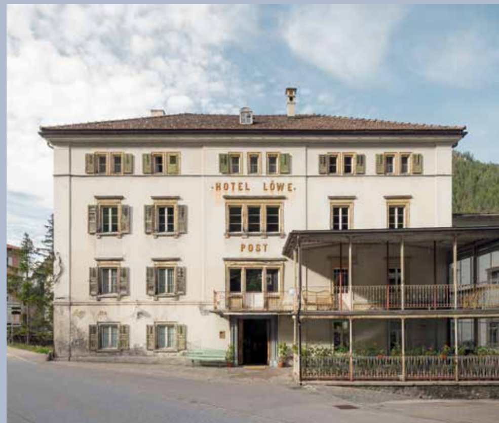
Die Fassaden des Post Hotel Löwe waren stark verwittert. Der Verputz löste sich von den Wänden.
